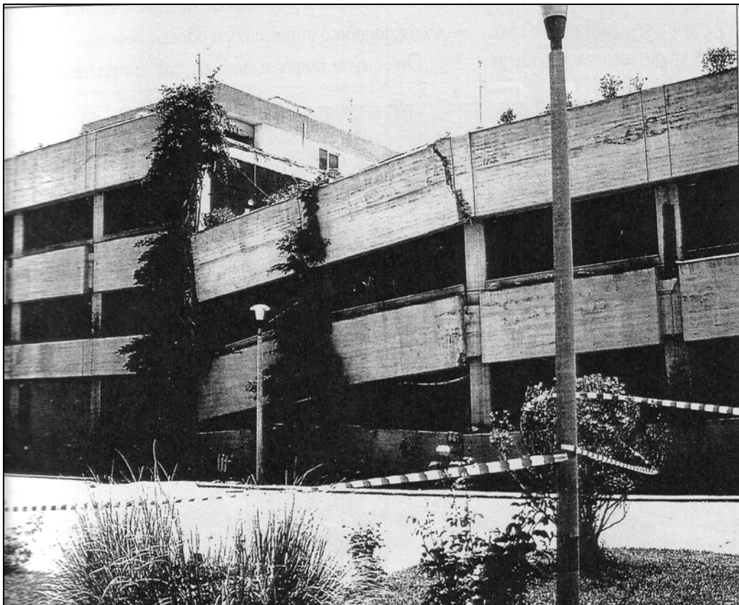
Εικόνα 7.2 : Βλάβες στο εργοστάσιο της Ελληνικής Βιομηχανίας Όπλων στο Αίγιο μετά το σεισμό του 1995 (Ε. Λέκκας,2000)
