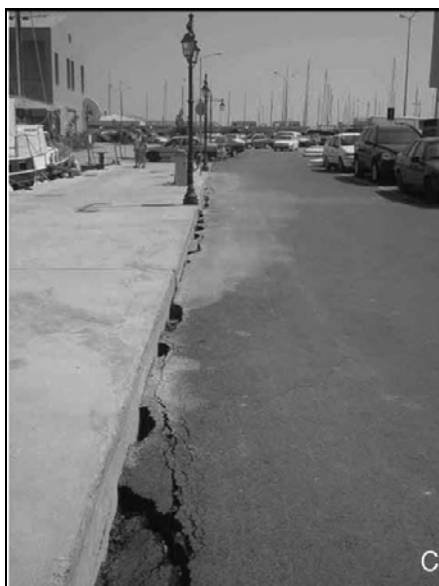
Εικόνα 9.2 : Οριζόντια μετατόπιση του πεζοδρομίου και έκλυση άμμου στη περιοχή της προβλήτας ( Papathanassiou et al, 2005)
